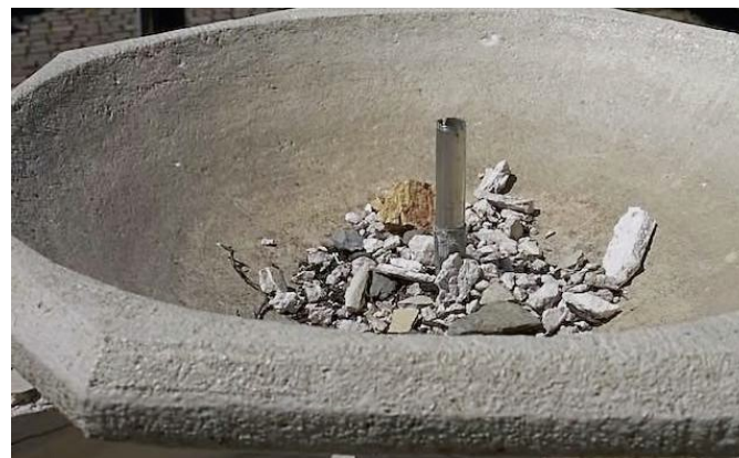
Das Gestein bröckelte und sammelte sich im Becken. So sah der Le Mêle-Brunnen vor Beginn der Sanierung aus.
